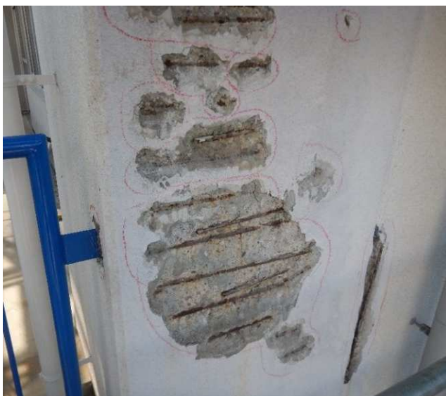
鉄筋が錆びてコンクリートが剥がれている
