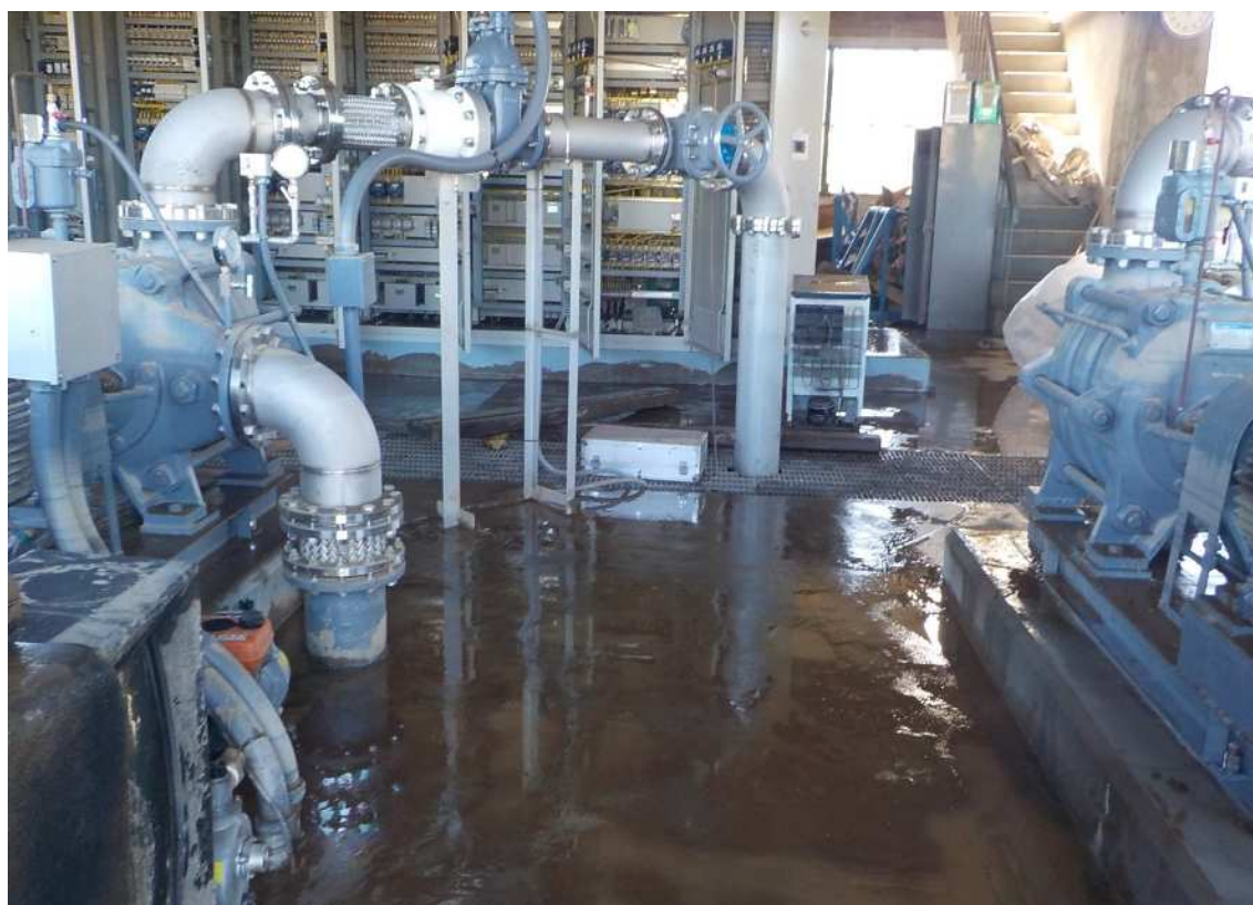
第一浄水場建屋内
